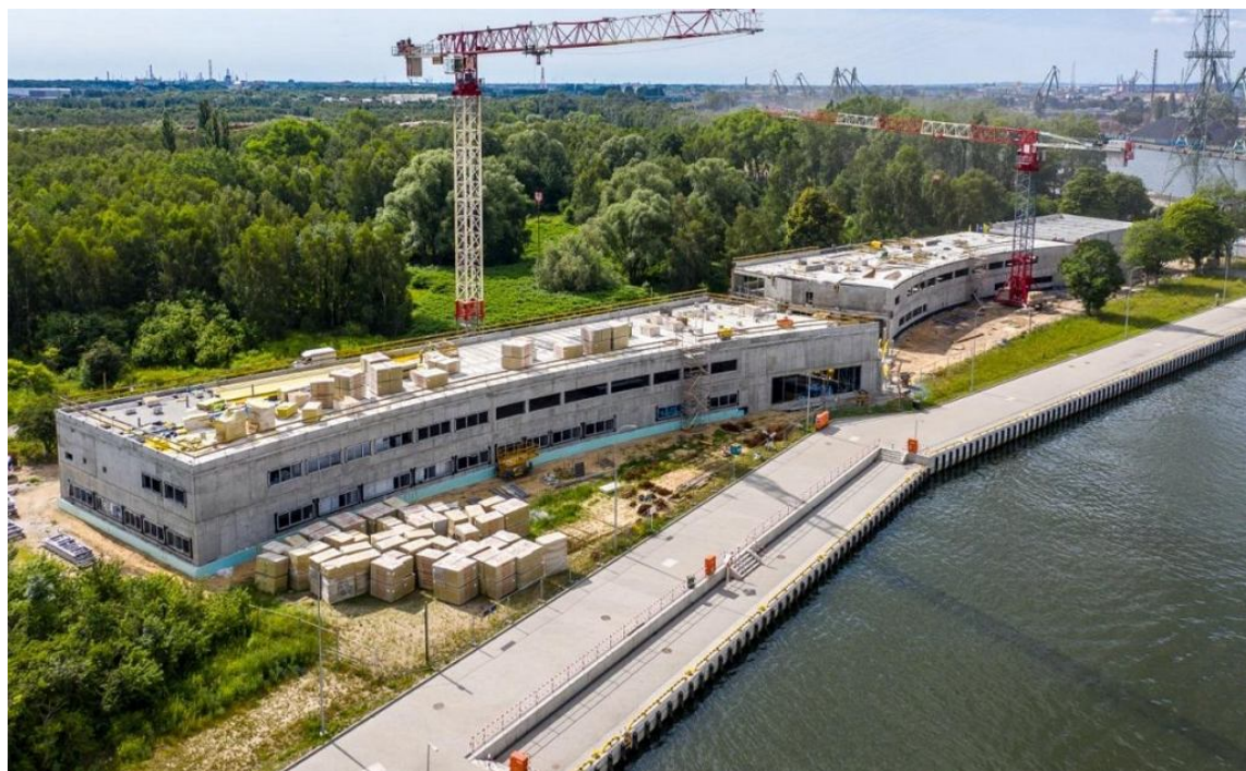
• Prace przy budowie Centrum Offshore Uniwersytetu Morskiego w Gdyni, które powstaje w bliskim sąsiedztwie Twierdzy Wisłoujście w Gdańsku, są już mocno zaawansowane mat.pras.
